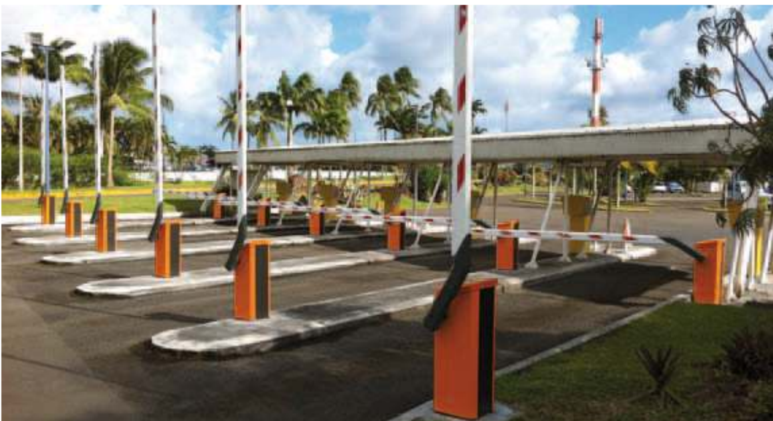
Barrières Magnetic.Parking utilisées comme SAS à l'aéroport Fort-de-France (Martinique).
